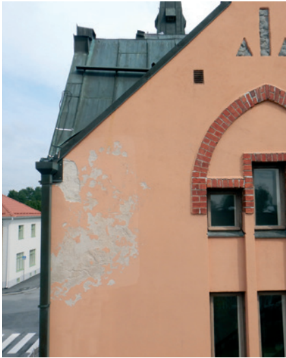
Fasaden på Brändö kyrka före renoveringen. På flera ställen hade putsen och färgen börjat släppa från underlaget, vilket var en av orsakerna till att renoveringen inleddes. Foto: A-insinöör.
